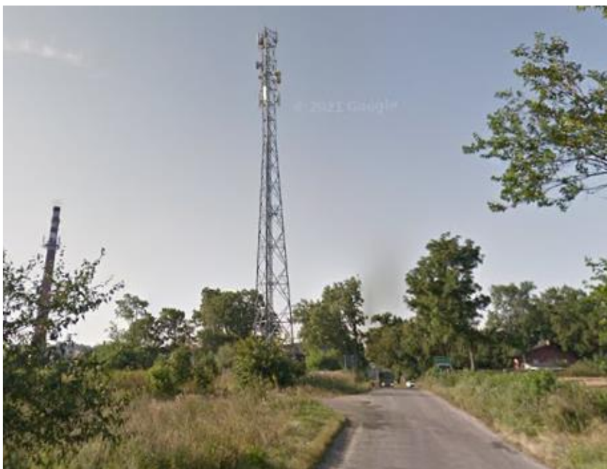
Fot. Stacja bazowa telefonii komórkowej
