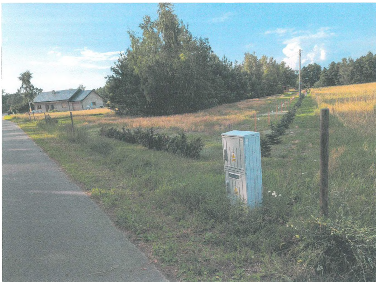
Załącznik 4. Fot. 2. Przyłącze elektroenergetyczne.
